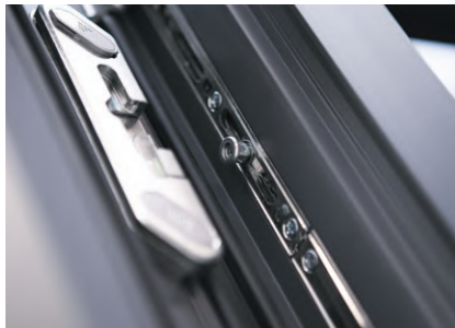
Multi secuair (rozszczelnienie okna)
